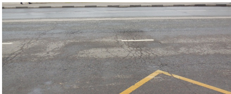
Рис. 3. Формирование выбоины в результате усталостного разрушения асфальтового бетона по краям морозобойной трещины
