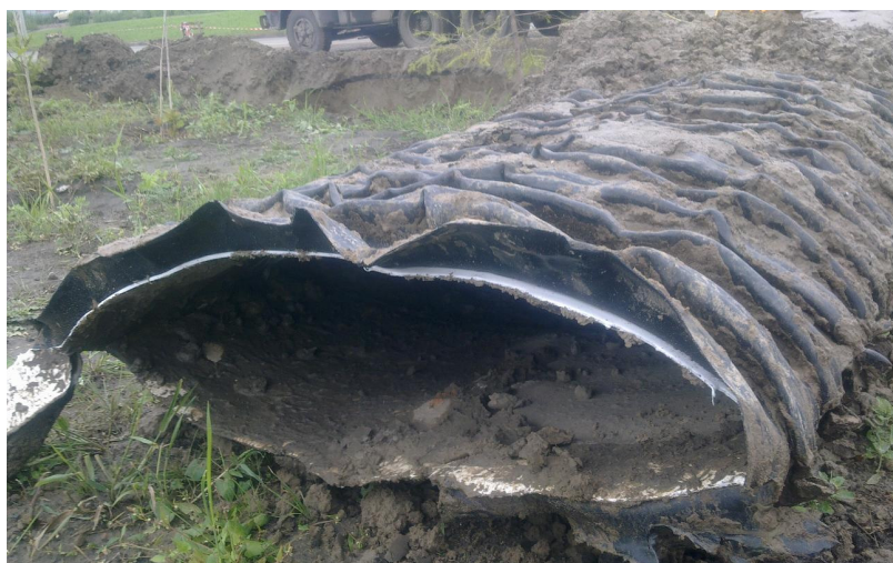
Рис. 1. Разрушение гофрированной полиэтиленовой трубы
