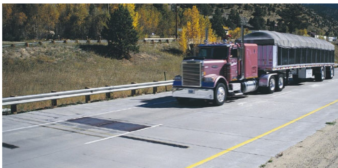
Рис. 7. Установленное оборудование на полосе движения для предварительного взвешивания автопоезда
