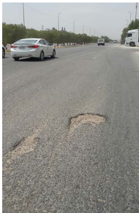
Рис. 4. Выбоины в г. Наджафе-ул-Хизаме (Ирак)
