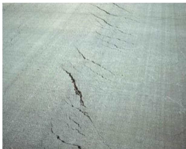
Рис. 7. Продольные трещины на новом покрытии
